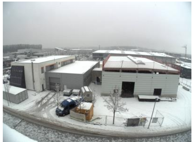
Baufortschritt zum Jahreswechsel: Dach und Wände stehen, bis Sommer 2022 soll das neue Lager- und Logistikzentrum fertiggestellt sein. Es wird auf ca. 1100 m 2 Grundfläche Platz für die Warenannahme, den Versand und das Lager für Materialien und Fertigprodukte bieten. Dank seiner Größe können auch voluminöse Sonderspeicher zwischengelagert werden.
