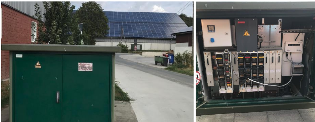
Einbausituationen der GridEye-Feldgeräte im Netz der Stadtwerke Ostmünsterland (Fotos: SW Ostmünsterland)
