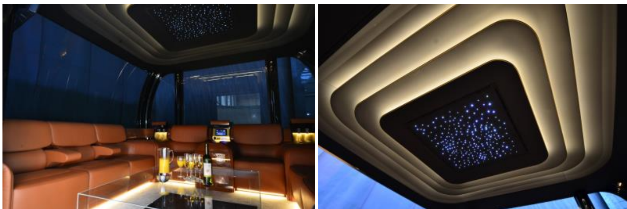
Himmlicher Klimakomfort: Dank der Spezialauslässe von LTG rund um den LED-Sternenhimmel erreicht die Zuluft gleichermaßen alle acht Sitze. (Bilder: CWA)
