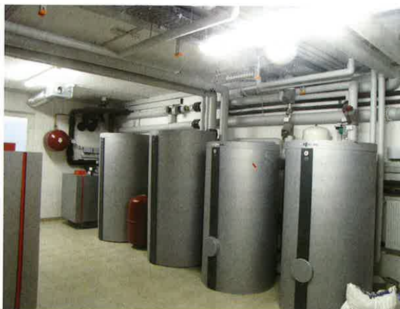
◀ Speichertanks in der Technikzentrale
