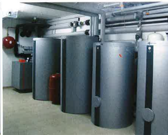
Speichertanks in der Technikzentrale
