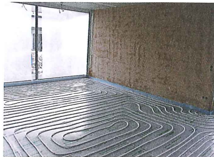
Die Fußbodenheizung im Wohnzimmer
