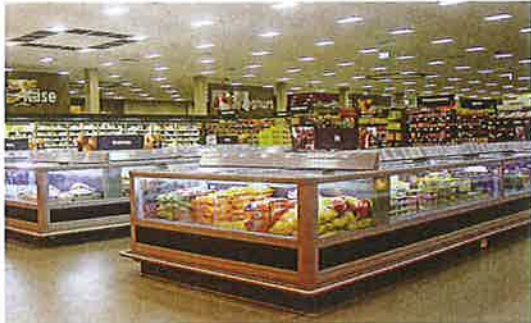
Das Kältesystem versorgt die verschiedenen Kühlmöbel im Markt, darunter Hauser IMM-XL Tiefkühlinseln von Hauser.
